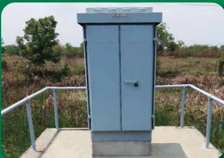
ตู้อุปกรณ์ควบคุมระบบอาณัติสัญญาณ
